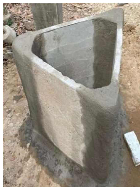
Figura 10. Sedimentador triangular construído com placas (Fonte: acervo pessoal do autor).
